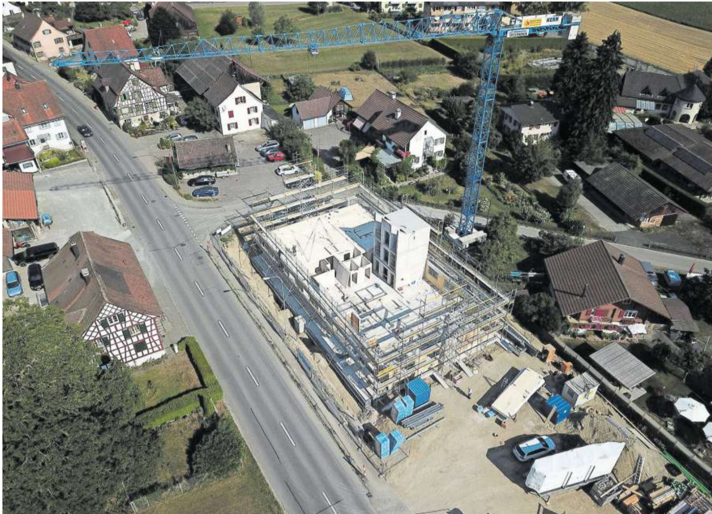
Das Wohn- und Gewerbehaus Schööfferwis in Kaltenbach ist in allen Bereichen planmässig auf Kurs.
